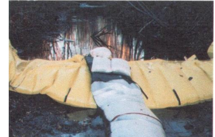
Desviador drenando el agua.
